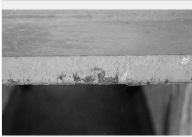
Edge / corner failure
